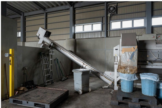
写真：搬送コンベア（2本目）
