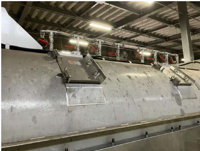
写真：処理施設の増設に合わせて導入された2号機には、メンテナンスや現地ヒアリングのフィードバックを盛り込んで改良を加えている
